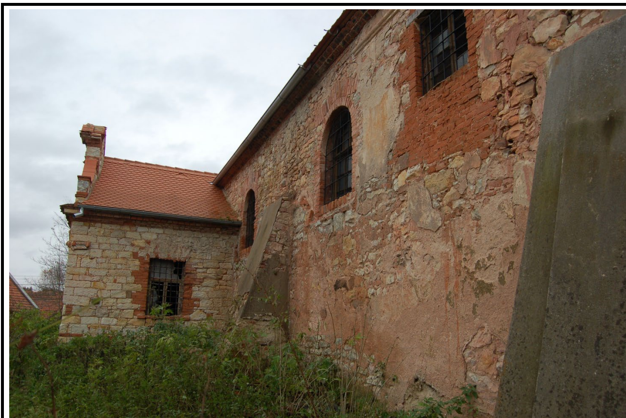
Severní průčelí lodi a západní průčelí sakristie v pohledu od severozápadu. Foto: Veronika Bartošová, 2007.
