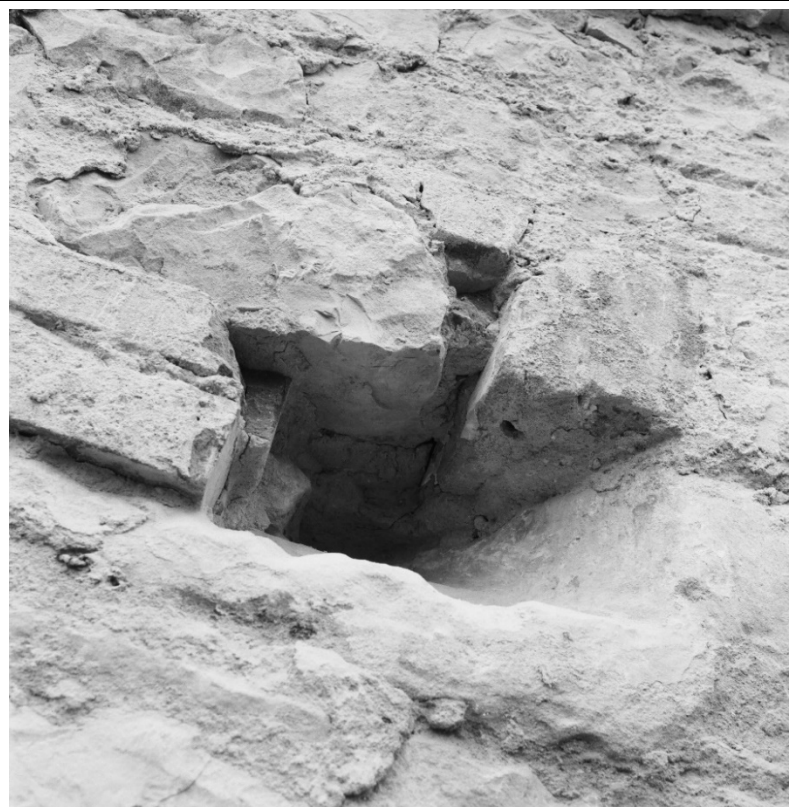
Detail středověkého zalděného východního okenního ostění jižního průčelí lodi. Foto: 1987, sbírka negativů NPÚ ÚOP v Ústí n. L., sign. 154667.
